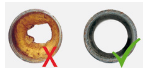
Sichtbarer Schutz für verborgene Werte: Kalkfreie Leitungen verhindern teure Sanierungen
