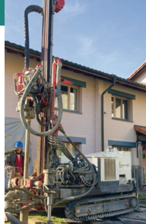
Kleinstes Bohrgerät der Schweiz: Dank dem kleinen Bohrgerät bohren die Profis zudem kostengünstig Erdwärmesonden – auch dort, wo andere Unternehmen das nicht mehr schaffen. Somit lassen sich die effizienten Wärmepumpen der Grünenwald AG an zusätzlichen Standorten sinnvoll nutzen. Die Abmessungen des Bohrgeräts sind auf der Firmen-Website abrufbar.
